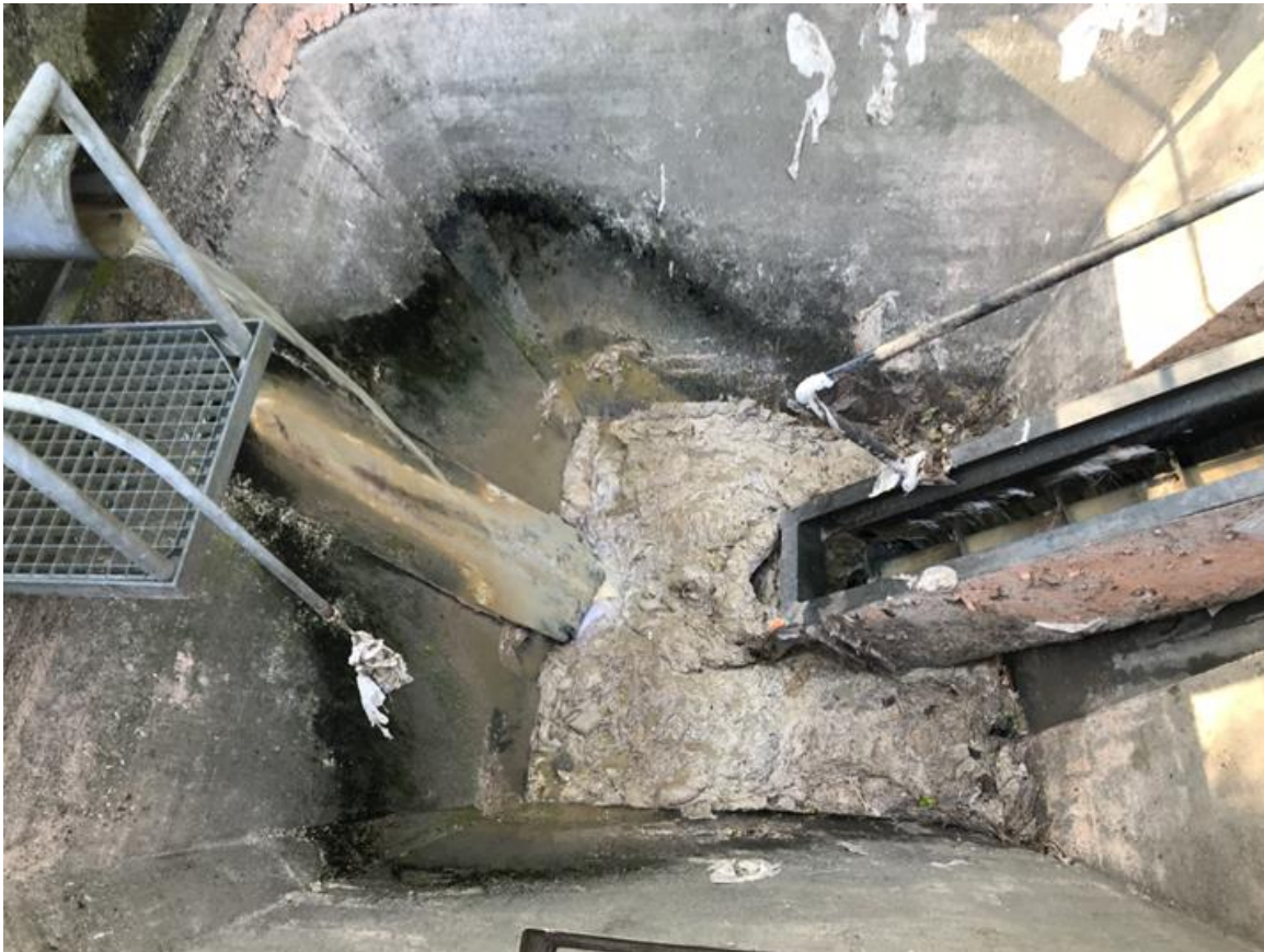
Abbildung 7: Alte ARA mit Unrat im Zulauf. Aktuell wird dieser im Regenfall grösstenteils in den Bach entlastet (Bild April 2018)
