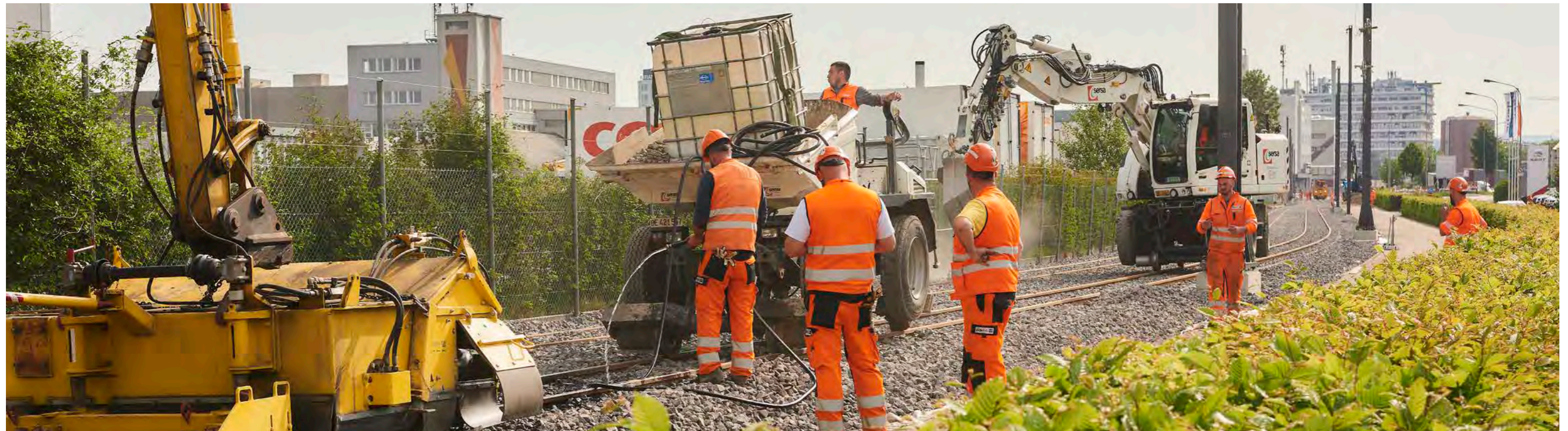
Die BLT ist für den Unterhalt und die Erneuerung der Infrastrukturanlagen der Linie 14 auf Baselbieter Boden zuständig.
