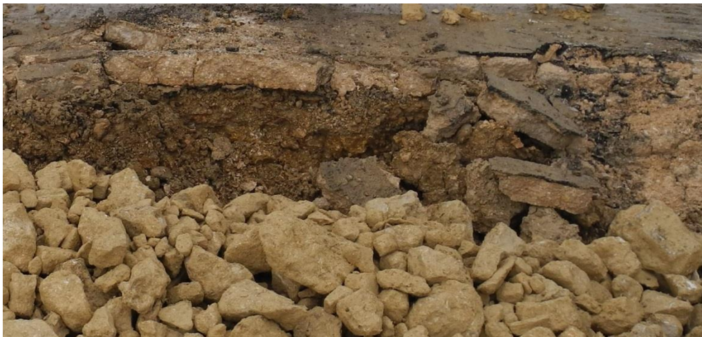
Abbildung 1: In der Vorstudie als nicht sanierungsbedürftig eingestuftes Wegabschnitt. Wenige Zentimeter Koffer, befestigt mit einer Spritzteerung. Die notwendige Sanierung ergibt entsprechende Mehrkosten.
