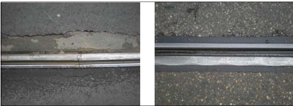
Abbildung 8: Typische Schadensbilder wie Belagsschäden infolge Gleissenkung, Schienenbruch, minimale Rillentiefe (Aufnahme links), starke Riffelbildung, minimale Rillentiefe (Aufnahme rechts)
