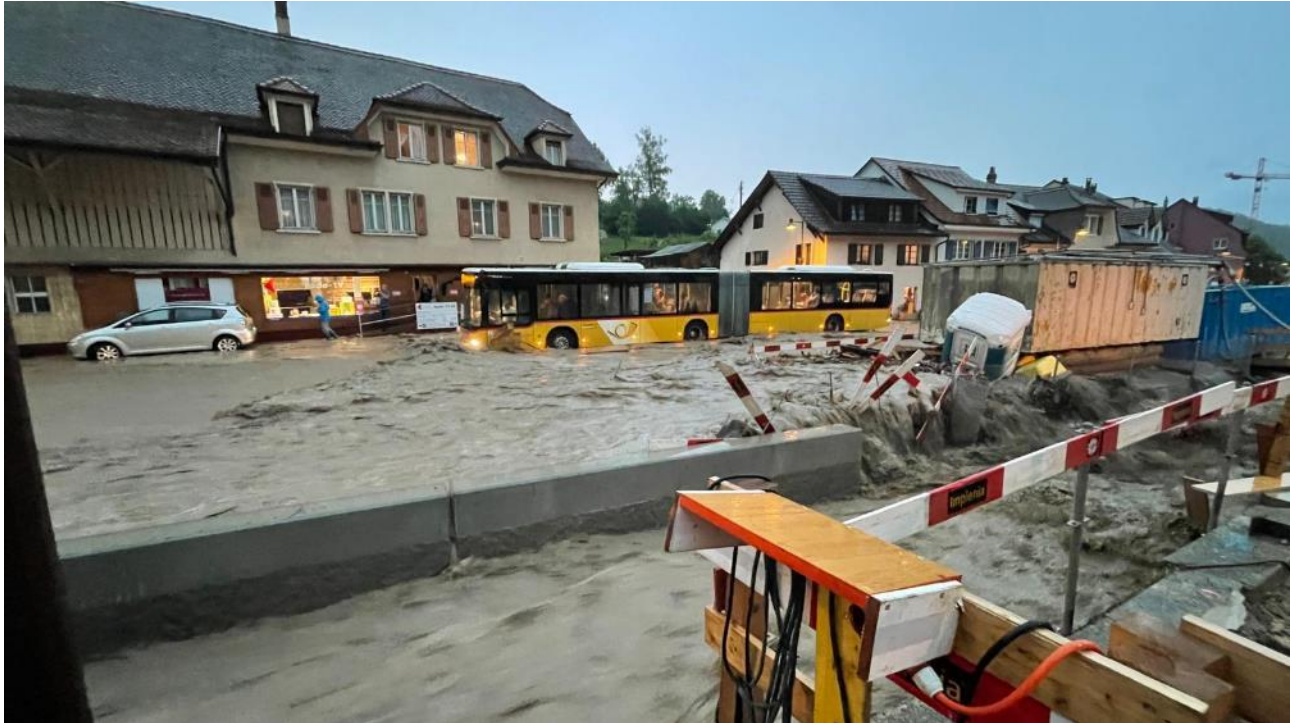
Abbildung 2: Hochwasser in Niederdorf am 23.06.2021 mit Flutung der Baustelle.
