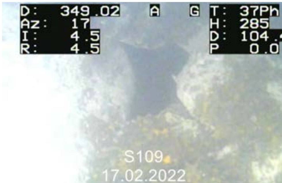
Abbildung 8: Videoaufnahme (axial nach unten, unterhalb des Rohrschuhs) vom 17.02.2022 der Produktionsbohrung S109 in einer Teufe von 349 m. Es sind lose Blöcke zu erkennen, woraus sich ein Teilverbruch der ursprünglichen Kaverne ableiten lässt. Der unterste Teil der LZRT ist abgerissen. Bohrlochaufnahme: Terratec Geophysical Services.
