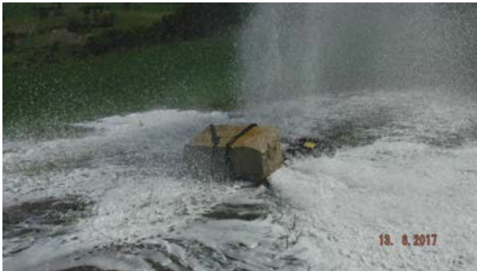
Abbildung 9: Soleaustritt nach Beschwerung des Schachtdeckels [3].
