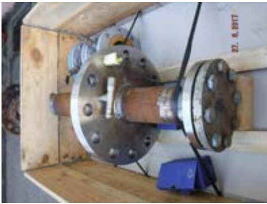
Flansch DN200, Rohrstück 4" und Blindflansch DN100 als Abschluss
