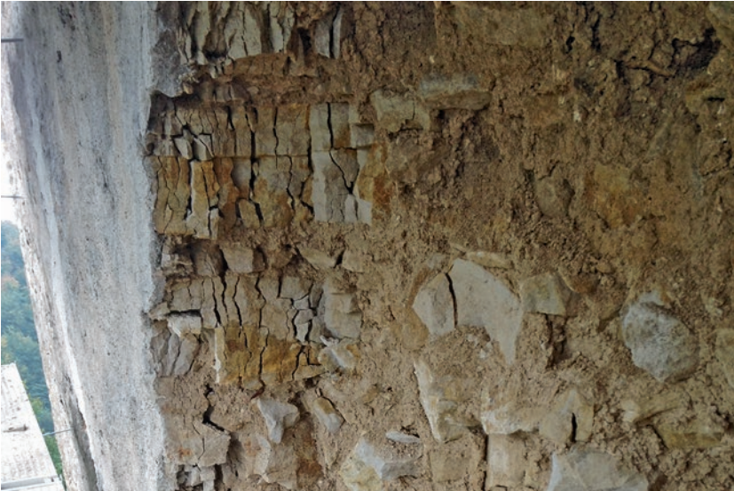
Schildmauer, Aussenseite: Unter dem Zementverputz einer älteren Restaurierung (links, ca. 1950–1980) waren die Steine durch Frost und Feuchtigkeit bis zu 40 Zentimeter tief komplett zerstört. Hier half nur ein aufwändiger Totersatz der Mauerschale.
