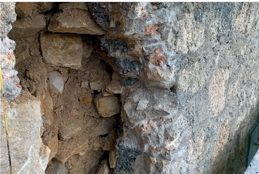
Schildmauer, Aussenseite: Eine jüngere Vormauerung unter Verwendung von viel Zement (ca. 1950, rechts) hat sich vom mittelalterlichen, stark zersetzten Mauerkern abgelöst.
