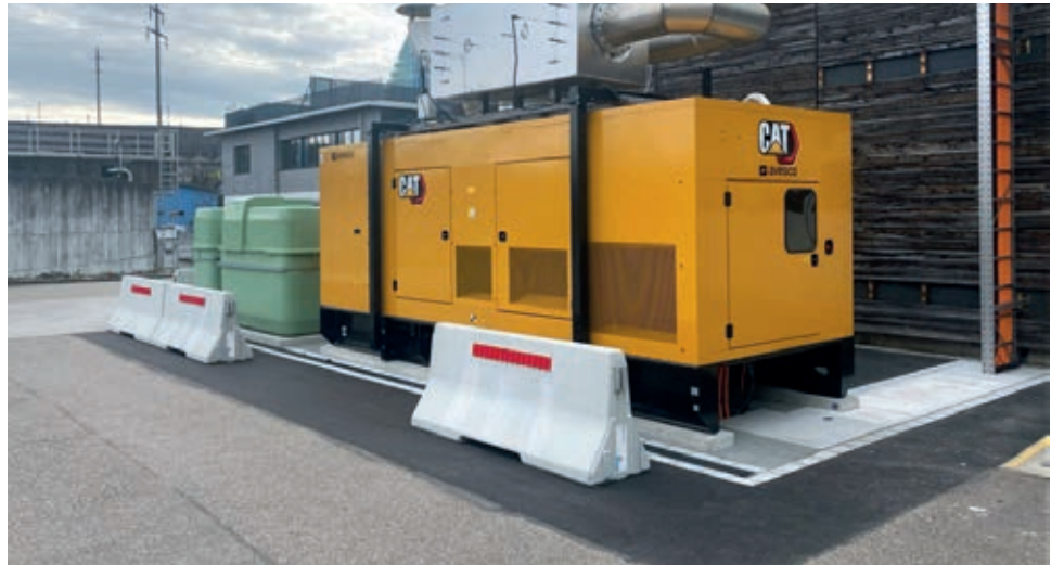
Notstromaggregat auf der ARA Birsi.
