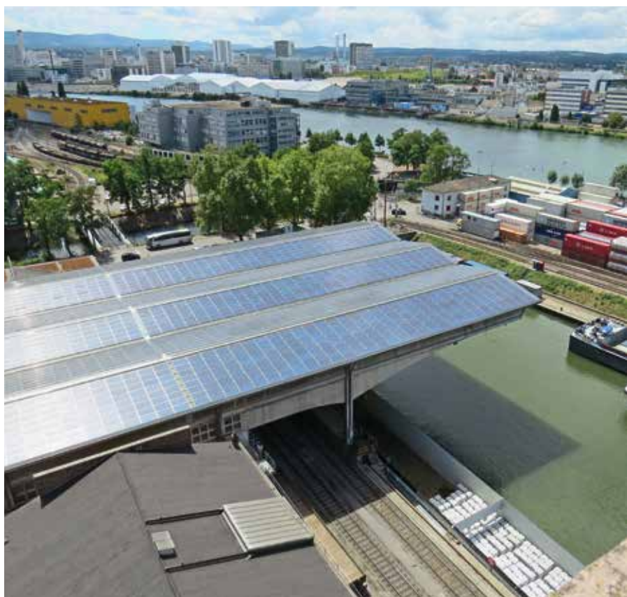
Solardach Rhenus Alpina AG im Stadthafen Kleinhüningen
