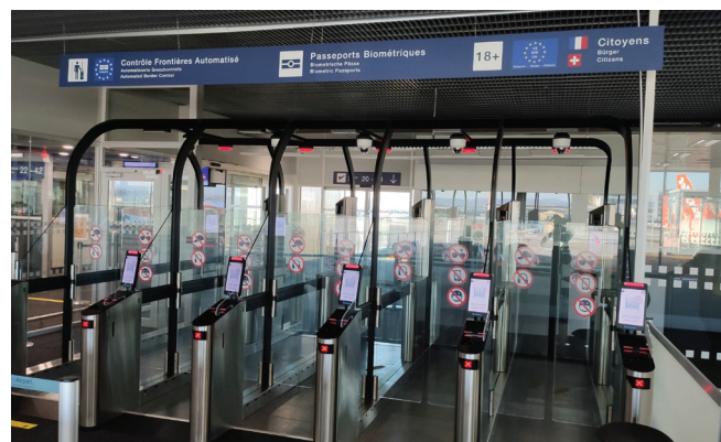
Neue Anlagen zur automatischen Passkontrolle
