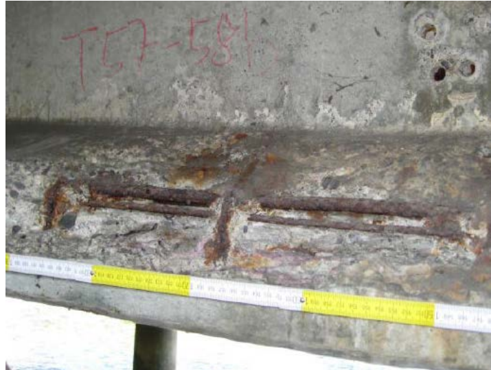
Abb. 08: Rost und Abplatzung an Längsträger
